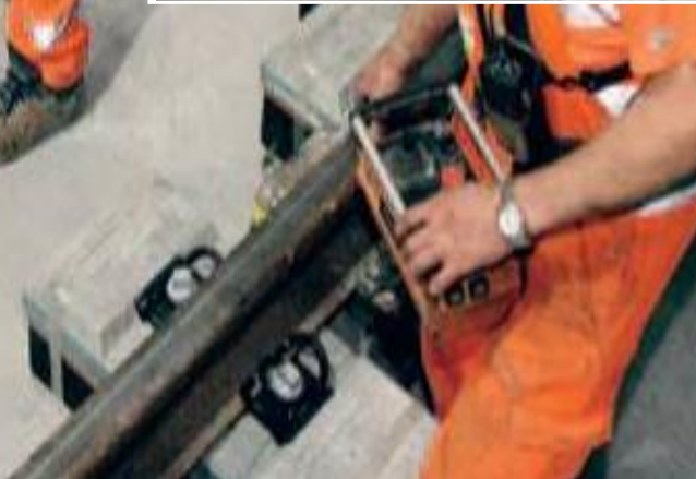
Schwellenschuheinlage im St. Gotthard Tunnel
