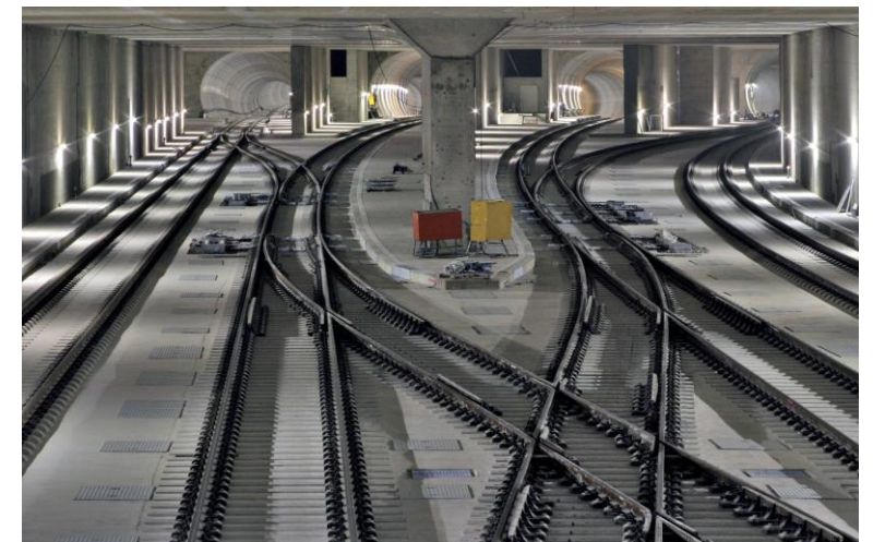
Masse-Feder-System – Nord-Süd Tunnel Berlin – Hauptbahnhof / Potsdamer Platz / Gleisdreieck
